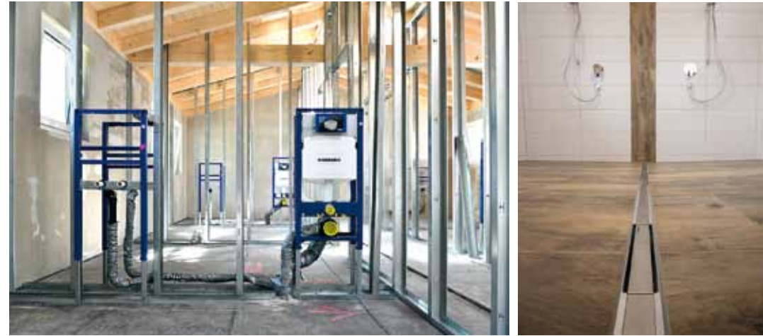
Die Sanitärtechnik im Neubau setzt sich aus Duofix Installationselementen für Waschtische, Urinale und WCs sowie aus Trinkwasser- und Entwässerungssystemen zusammen.
